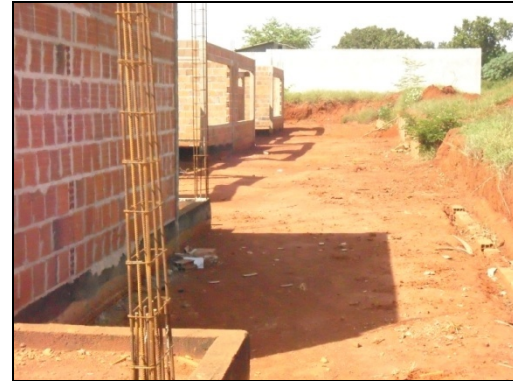
Imagem 04: Armadura não concretada Exposta a agentes do ambiente que provocar a sua corrosão.
