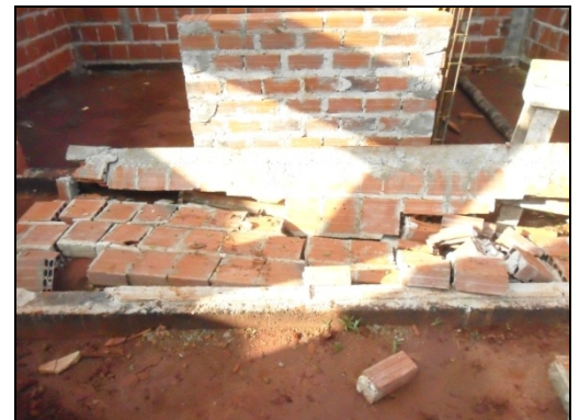
Imagem 02: Parede interna no chão.
