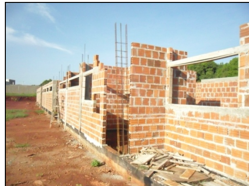
Imagem 12: Limpeza precária na obra.
