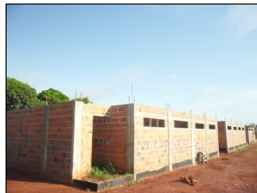
Imagem 08: Entrada de sala com muito mato.
