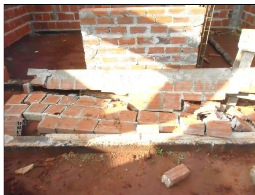
Imagem 02: Parede interna no chão.
