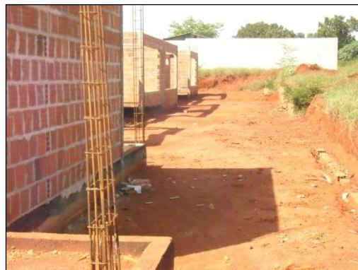
Imagem 04: Armadura não concretada Exposta a agentes do ambiente provocar a sua corrosão.
